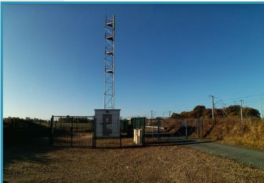
Prise de vue B' : Vue en direction du sud-ouest sur l'antenne relais SNCF réseau
